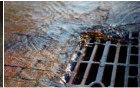
Abb. 2: Dreckiges Wasser gelangt in die Kanalisation.
